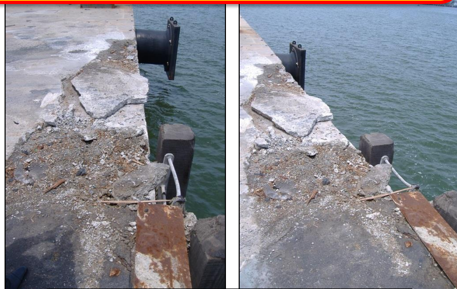
「うねり」により損傷したバース
